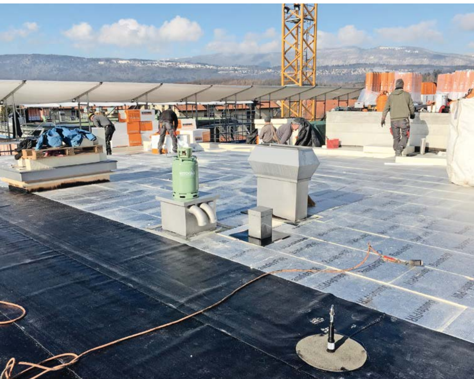
Gefährdete Dichtigkeit: Dächer müssen immer mehr Aufbauten tragen, dazu viel Material und Menschen während der Bauzeit.
