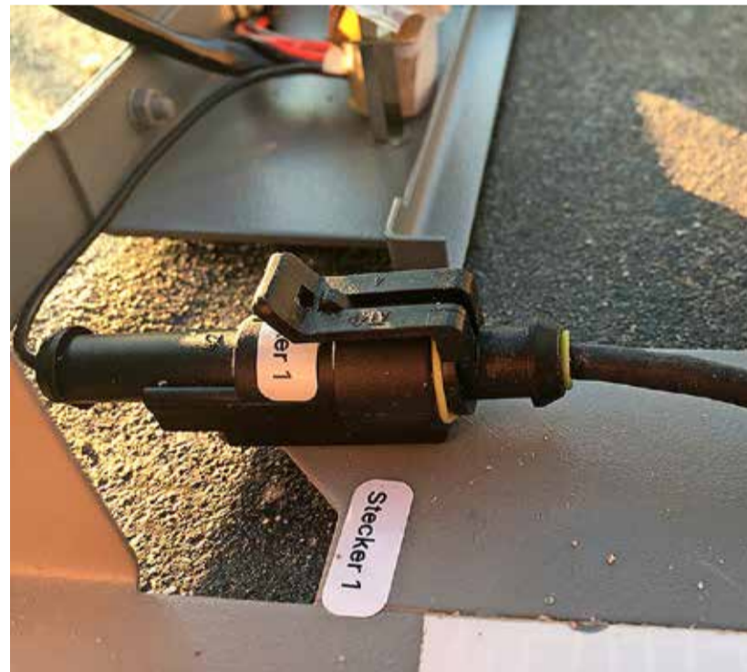
Die im Dachaufbau verlegten Potenzialkabel und die Sensorbox werden über Stecker verbunden. Sobald Wasser eintritt, stellt das System einen Kontakt her.
